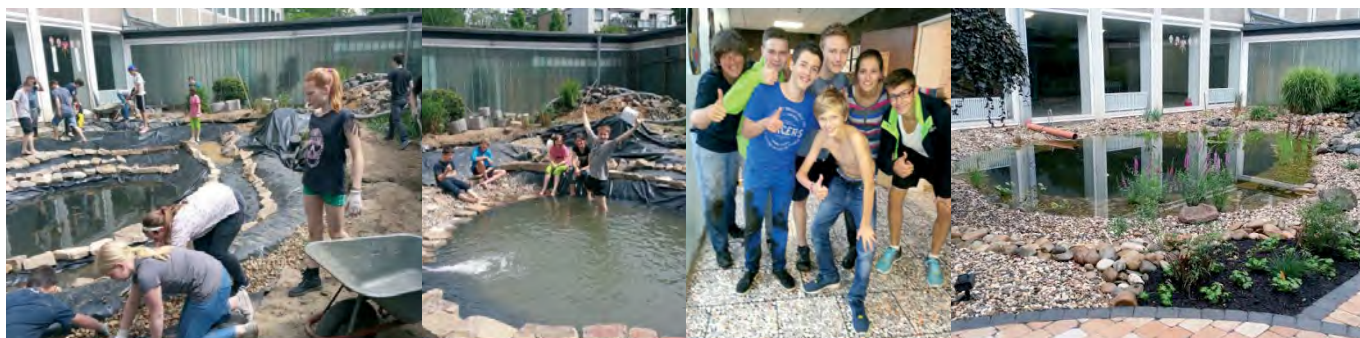
Neue Teichfolie wird verlegt und die Uferlinie befestigt - ENDLICH! Wasser marsch! - TOP-Mannschaft! - Gretchen-Atrium heute
